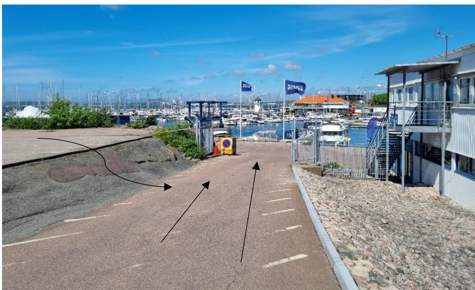
Figur 5: Foto från platsbesök, väg ner till båtuppställningsplatsen, pilar visar vattnets rinnväg
